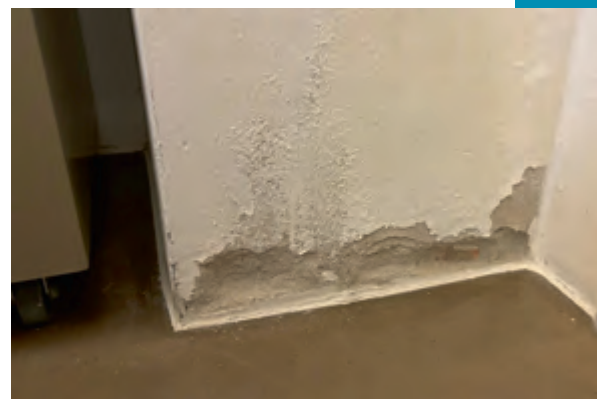
Es bröckelt, rieselt, blättert und sickert: Das historische Gebäude des Bezirksmuseums ist stark sanierungsbedürftig.
